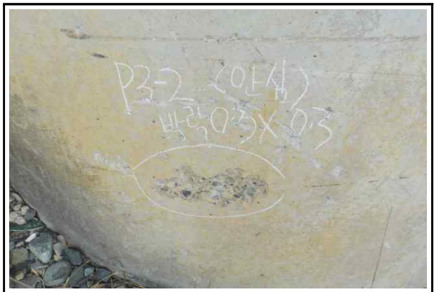
손상위치 : 교각(P3-2, 기둥부)
