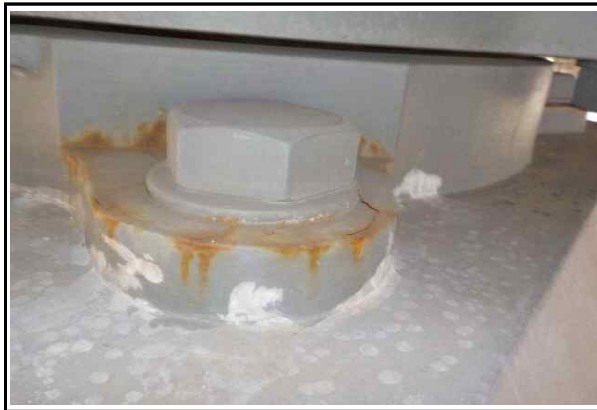
손상위치 : 받침장치(P4, SH6)
