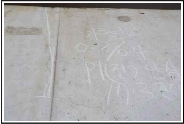
손상위치 : 교각(P1, 코핑부)
