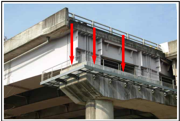
손상위치 : 교각(P3, 코핑부)
