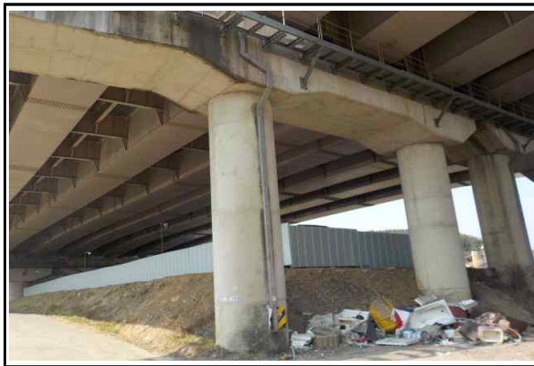
손상위치 : 교각(P3, 코핑부)
