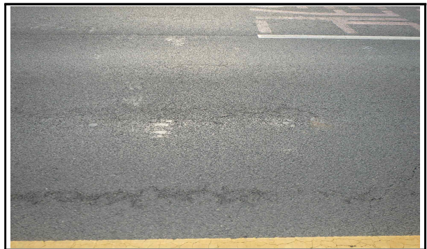
손상위치 : 교면포장(S1, 안심방향)
