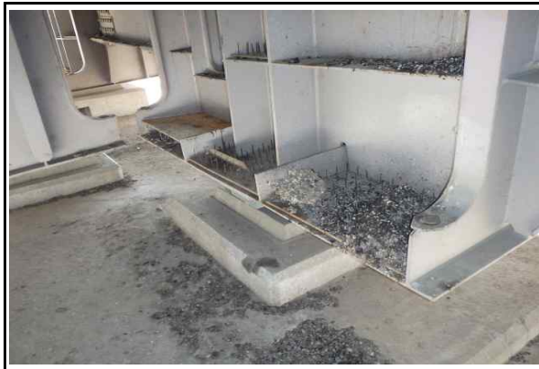
손상위치 : 거더 외측 지점부
