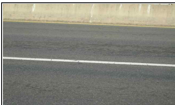
손상위치 : 교면포장(S3, 안심방향)
