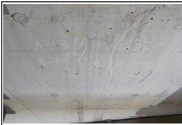
손상위치 : 교각(P2, 코핑부)
