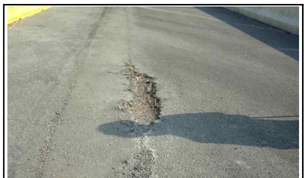
손상위치 : 교면포장(S2, 범물방향)
